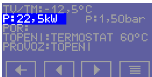
P: OKAMŽITÝ VÝKON KOTLE
